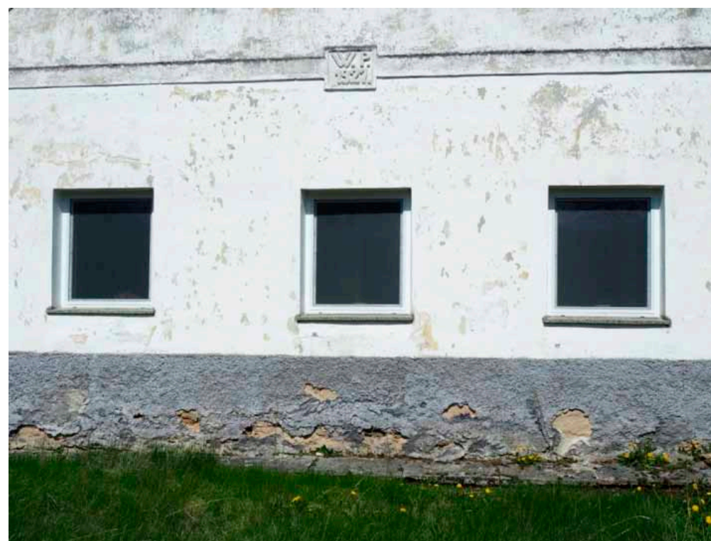
✗ Nevhodný typ nečleněných oken je cizorodým prvkem fasády
