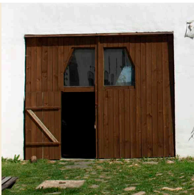
✗ Nevhodná novodobá úprava vrat
