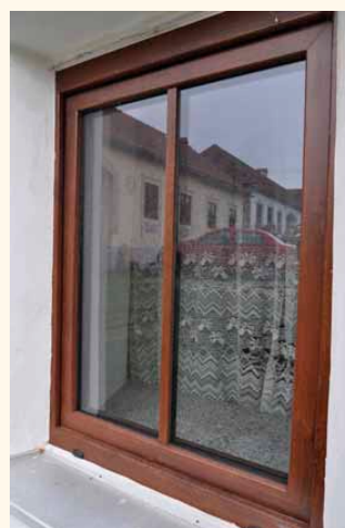
✗ Nevhodné použití plastového okna
