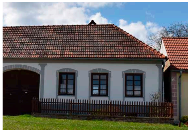
✗ Vlevo - doplnění neautentických šambrán, vpravo – starší stav fasády
