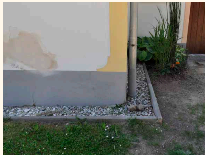
✗ Nevhodné řešení obrubníku, vystupujícímu nad terén
