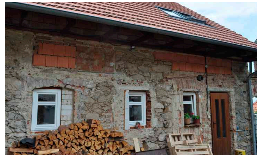
✗ Nepříjemné řešení plastových oken ve dvorní části domu
