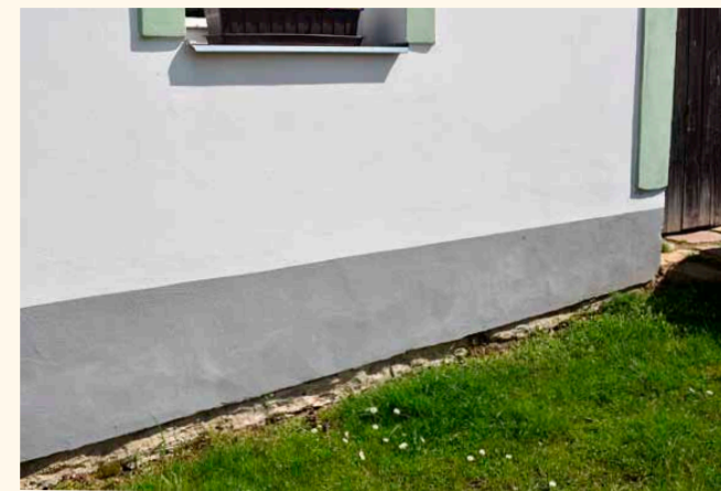
✗ Tvrdé odříznutí soklové části fasády od terénu
