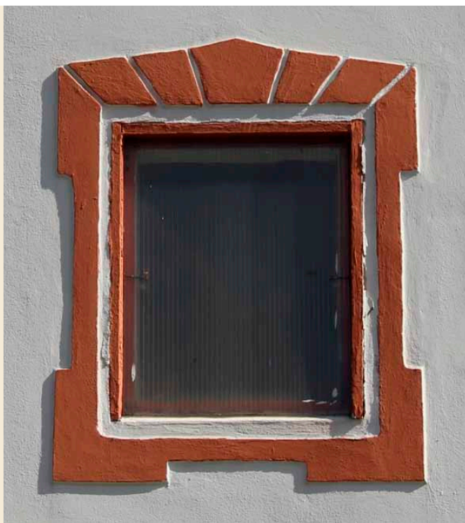
✗ Nevhodné zasklení okna
