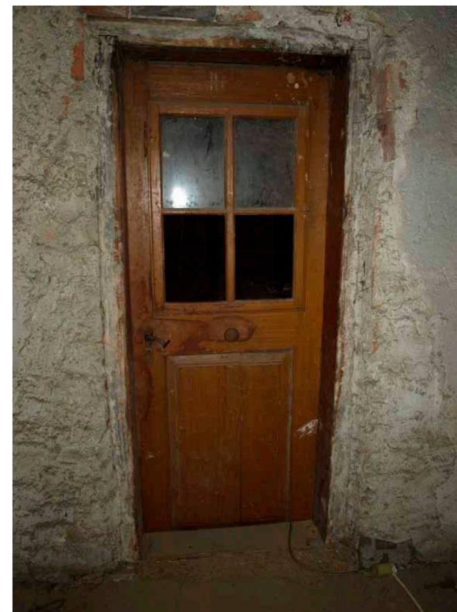
✗ Nevhodné zacházení s druhotně použitými dveřmi je jejich uříznutí či jiné poškození
