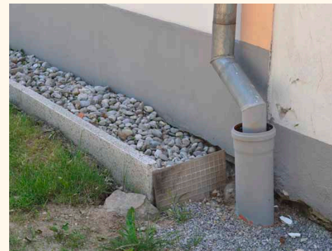
✗ Nevhodný způsob drenáže vymezené vysokými obrubníky, tvořící pohledově tvrdý předěl mezi trávníkem a soklem
