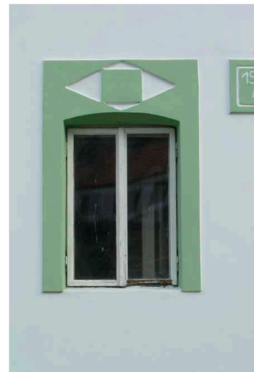
✗ Novodobá nevhodná úprava okna
