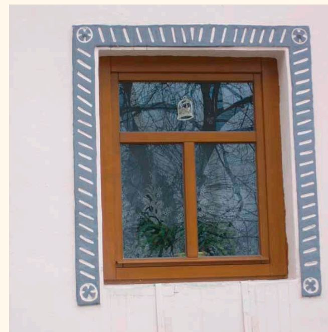
✗ Použití nového tradičně užívaného trojdílného okna avšak bez profilace působí nepřírozně
