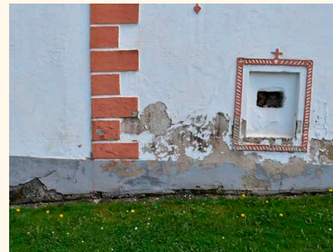
✗ Chybí pravidelná a častější údržba ohrožených soklových partií fasády
