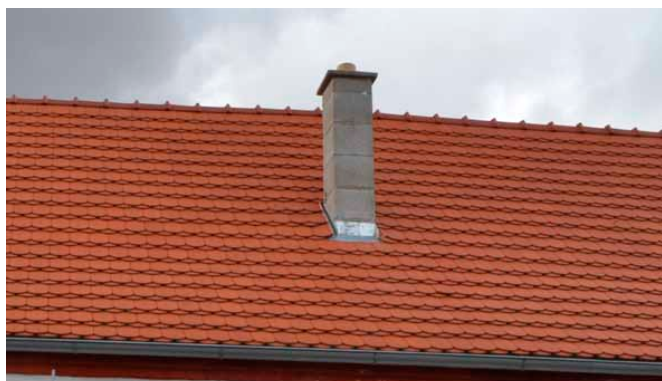
✗ novodobý subtilní komín ze systémových tvarovek
