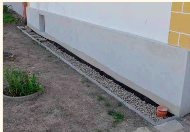
✗ Nepřírozené řešení s pohledově rušivým momentem vystupující nopové fólie nad terén
